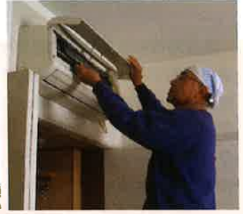
▲エアコンの清掃
